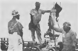
E HENDENAN di Pipe craft ta instala e mashien hot tap, portret ariba, na e valve. Mientras W. Bailey, banda robes den portret mas baxo, ta waak e indicator. Geerman, banda drechi, ta laga aire bai pa e motor di e cortador.
